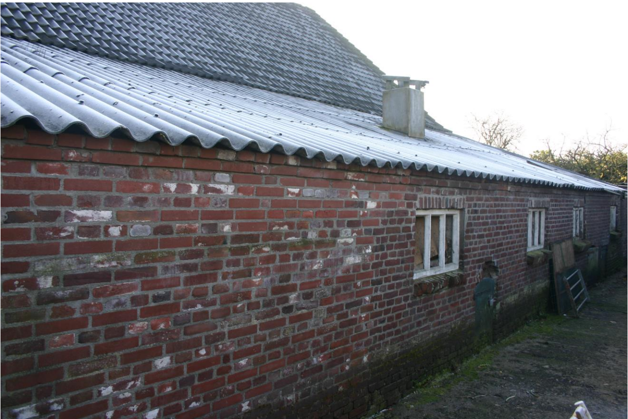
Figuur 4.2.1. Tussen het eternieten dak en het daaronder aanwezige plafond van de inpandige stierenstal bevinden zich geen verblijven van beschermde diersoorten.
