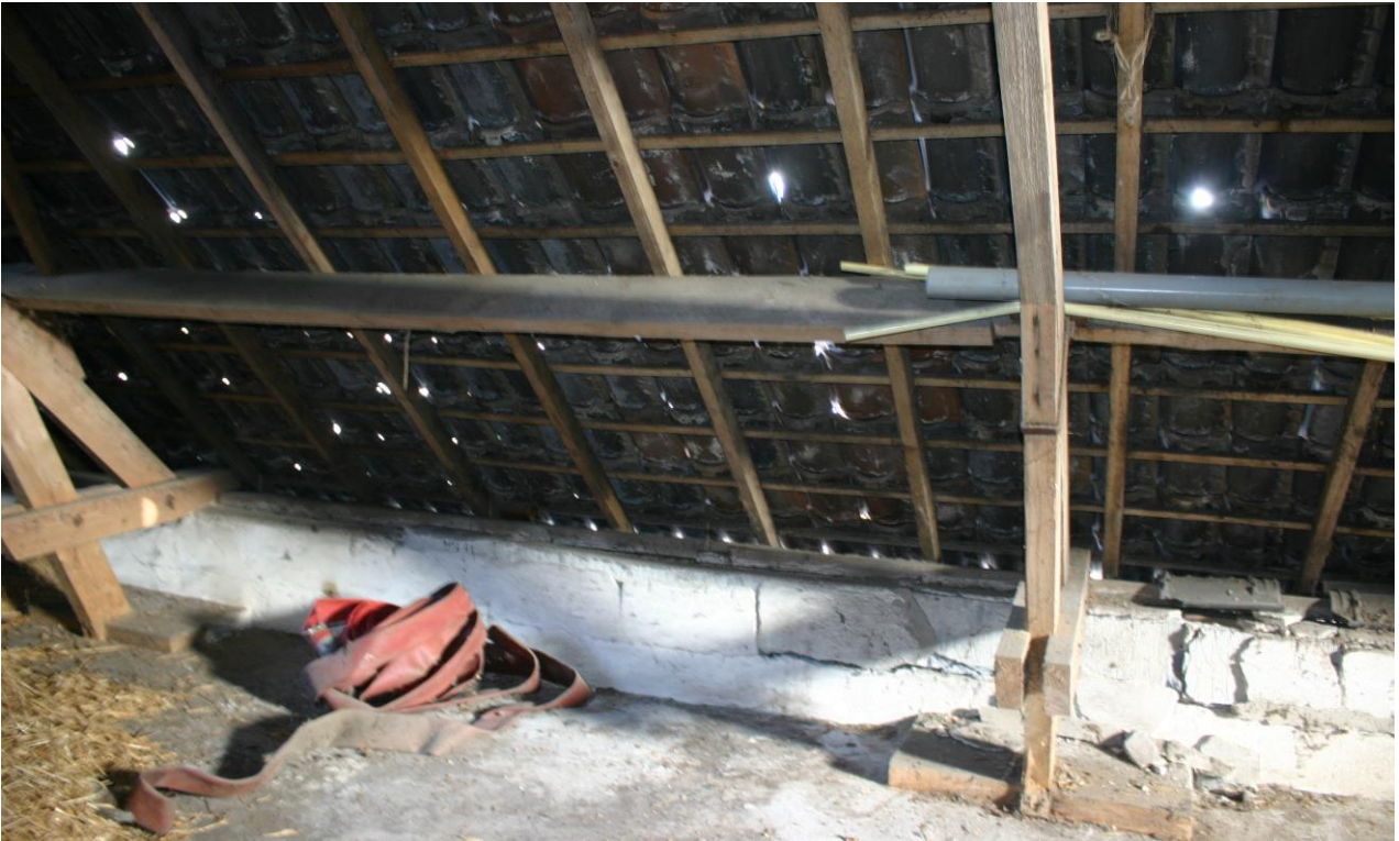
Figuur. 4.5.1. De zolder van de voormalige koeienstal geeft uilen, dankzij de volledig intacte ramen, geen toegang. Voor vleermuizen is deze echter makkelijk bereikbaar, door de gaten in de dakbedekking.
