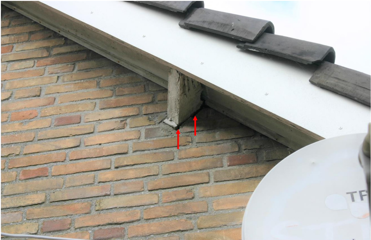
Figuur 4.5.3. De voormalige koeienstal heeft op diverse plaatsen gaten en scheuren in het buitenblad, waardoor vleermuizen de achterliggende spouw kunnen bereiken.
