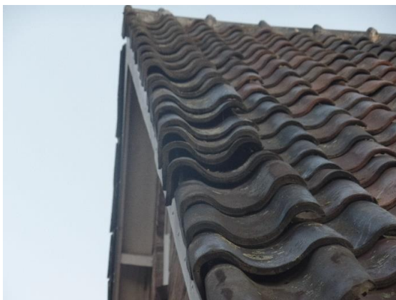
Figuur 2. Losliggende nokpannen op de schuur.
