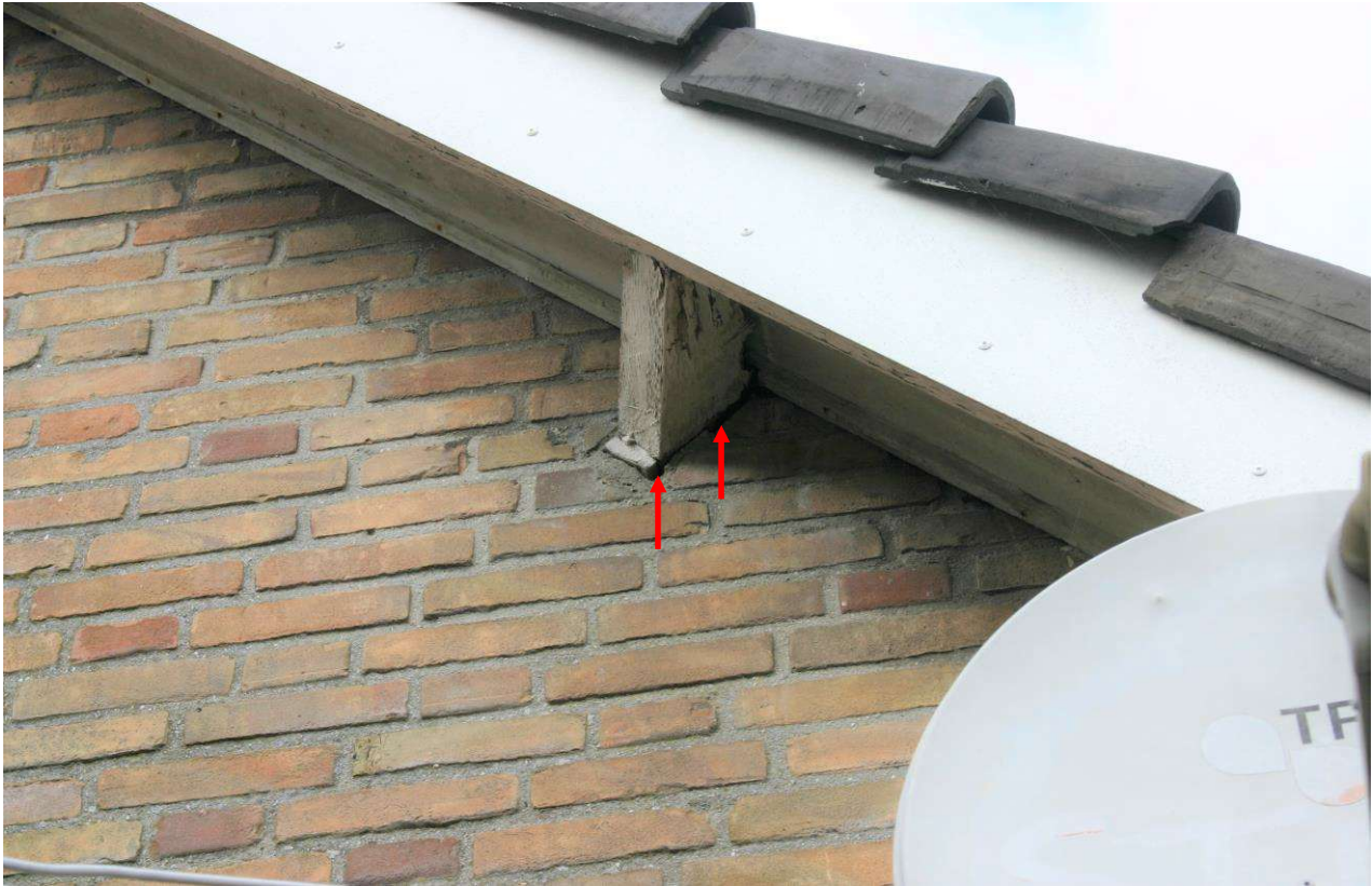
Figuur 4.5.3. De voormalige koeienstal heeft op diverse plaatsen gaten en scheuren in het buitenblad, waardoor vleermuizen de achterliggende spouw kunnen bereiken.
