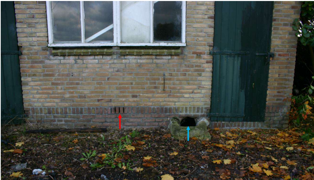
Figuur 4.5.4. In de gevels van de voormalige koeienstallen bevinden zich ventilatiegaten (rode pijl) op kniehoogte en gaten (blauwe pijl) naar de gierkelders.
