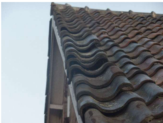
Figuur 2. Losliggende nokpannen op de schuur.
