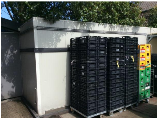
Koelcellen in- en uitpandig
