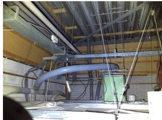
Metalen en kunststof installaties boven het systeemplafond
