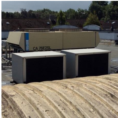
LBK installaties op het dak
