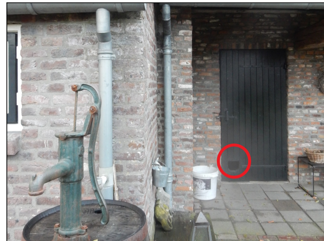
Figuur: gat in de deur van het achterhuis waardoor de schuur toegankelijk is voor steenmarter.
