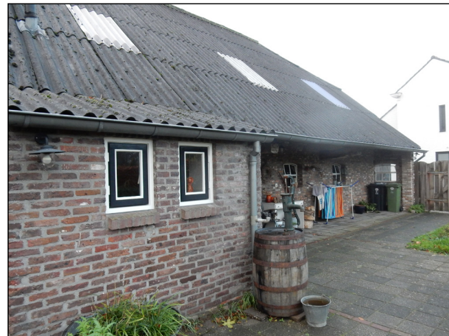
Figuur: zijgevel van het achterhuis aan de tuin kant. Huismusverblijven zijn niet mogelijk omdat er geen ruimte is onder de golfplaten.
