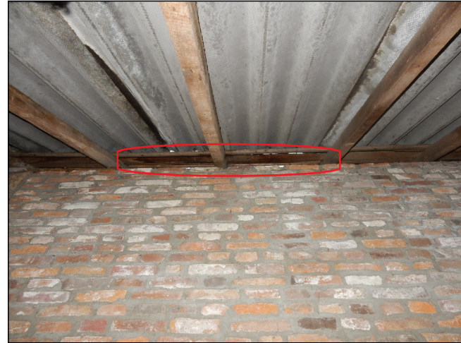
Figuur: ruimte van een paar centimeter tussen de platen van het dak en de muur van het achterhuis. Kleine vogels kunnen hierdoor naar binnen gaan.
