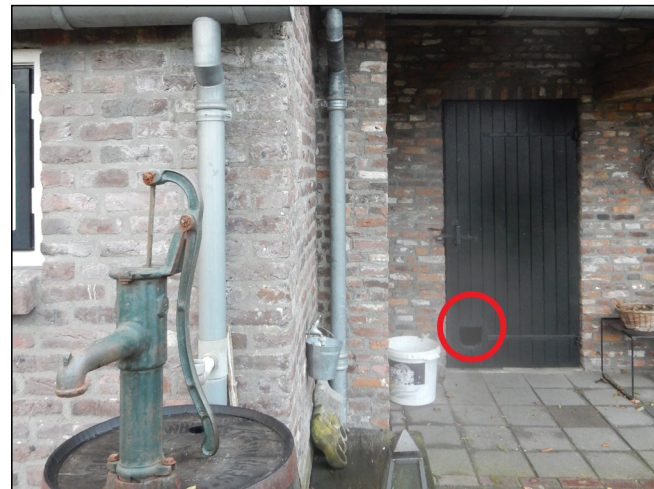
Figuur: gat in de deur van het achterhuis waardoor de schuur toegankelijk is voor steenmarter.
