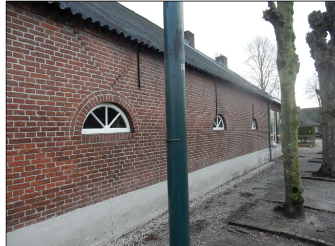
Figuur: zijgevel van het achterhuis. Er is geen ruimte onder de golfplaten voor huismussen om verblijven te hebben.
