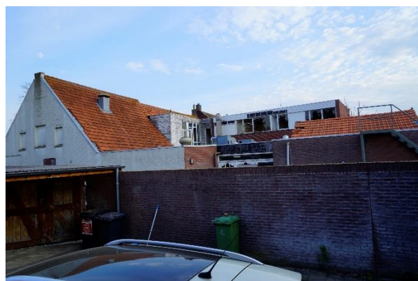
Achterzijde van Salt and Pepper. Verval van het gebouw en gebroken ramen is goed zichtbaar.
