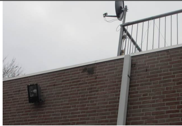
Fig. 13, Poepsporen op muur met open stootvoegen
