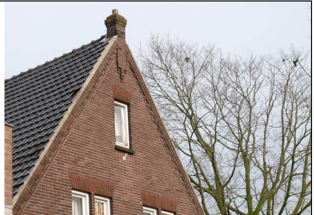
Fig. 12, Dak met opening voor vogels en/of vleermuizen.
