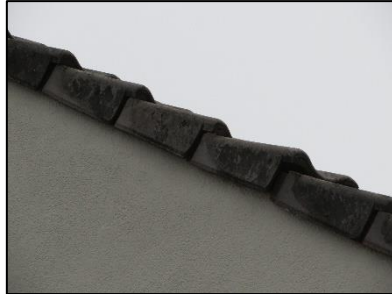
Figuur 16. Overhangende dakpannen (horeca)
