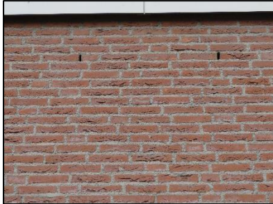
Figuur 15. Open stootvoegen en overhangende dakrand (sporthal)
