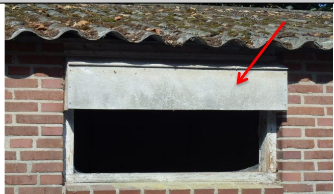
Foto nr. 7, luchtkasten van schuur 3, M 3 asbesthoudend
