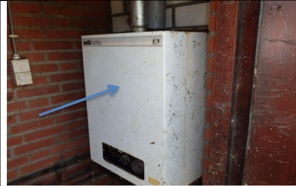
Foto nr 16 CV HR ketel geen asbest
