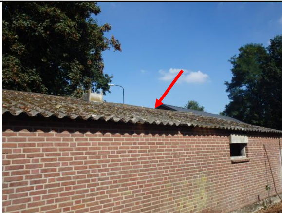
Foto nr. 4, Golfplaten van dak schuur 3, identiek aan M 1 asbesthoudend
