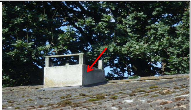
Foto nr. 9, luchtkasten van dak schuur 3, identiek aan M 3, asbesthoudend
