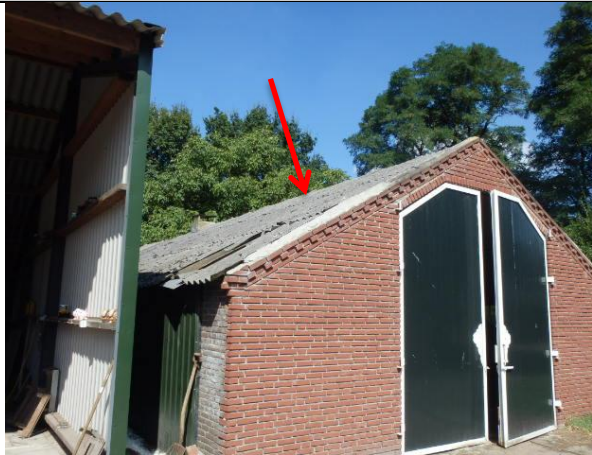
Foto nr. 14, Golfplaten dak schuur 8, M 1 asbesthoudend
