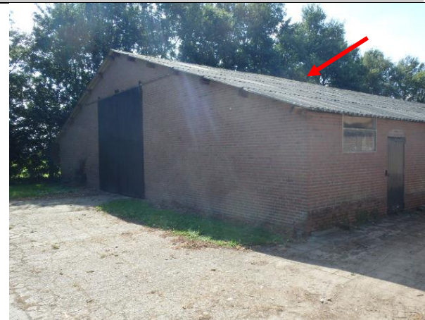
Foto nr. 1, Golfplaten van dak schuur 2, identiek aan M 1 asbesthoudend
