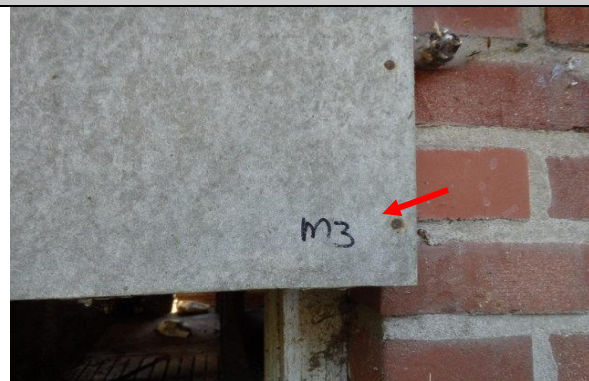
Foto nr. 6, Luchtkasten van schuur 3, M 3 asbesthoudend
