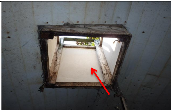
Foto nr. 10, luchtkasten van dak schuur 3, identiek aan M 3 asbesthoudend
