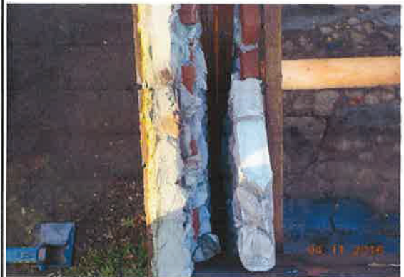
Foto 8 Detail foto spouw schuur 8
