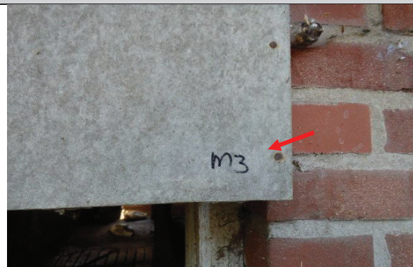
Foto nr. 6, Luchtkasten van schuur 3, M 3 asbesthoudend
