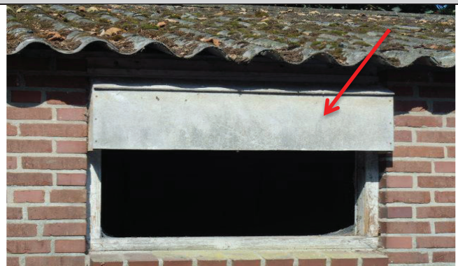
Foto nr. 7, luchtkasten van schuur 3, M 3 asbesthoudend
