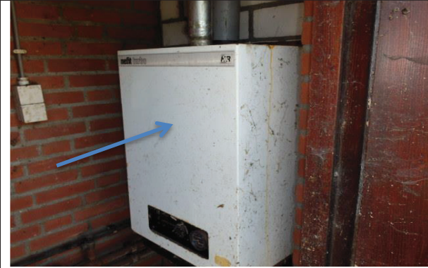
Foto nr 16 CV HR ketel geen asbest
