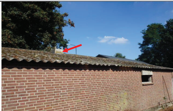
Foto nr. 8, Luchtkasten van dak schuur 3, identiek aan M 3 asbesthoudend
