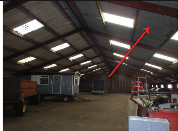
Foto nr. 2, Golfplaten van dak schuur 2, identiek aan M 1 asbesthoudend
