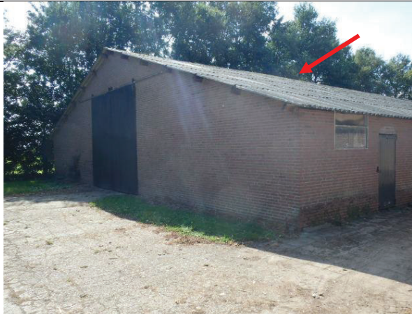
Foto nr. 1, Golfplaten van dak schuur 2, identiek aan M 1 asbesthoudend
