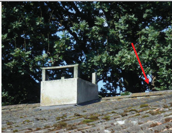
Foto nr.5, Nokvorsten van dak schuur 3, Identiek aan M 2 asbesthoudend
