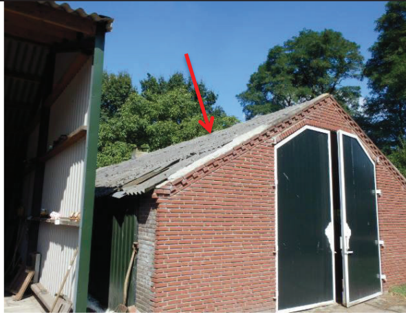
Foto nr. 14, Golfplaten dak schuur 8, M 1 asbesthoudend
