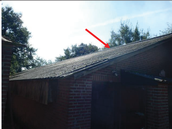
Foto nr. 11 , Golfplaten van dak schuur 5, identiek aan M 1 asbesthoudend
