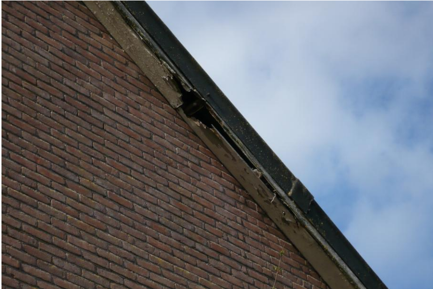
Foto 3. Boeiplaten aan de achterzijde van de grote schuur (foto: A&W)
