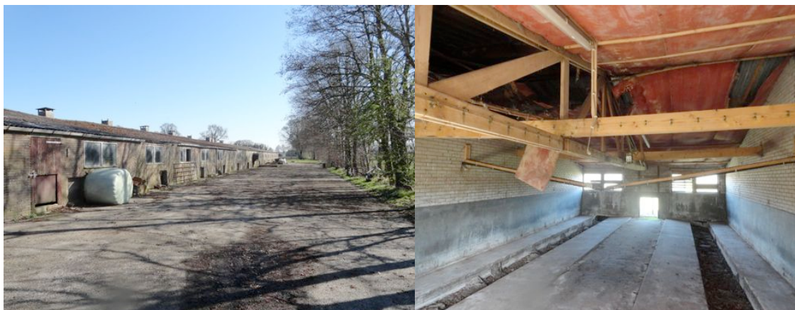
Foto 1 en 2 Voormalige kalverfokstal, nu in verval (links); rechts interieur van deze stal
