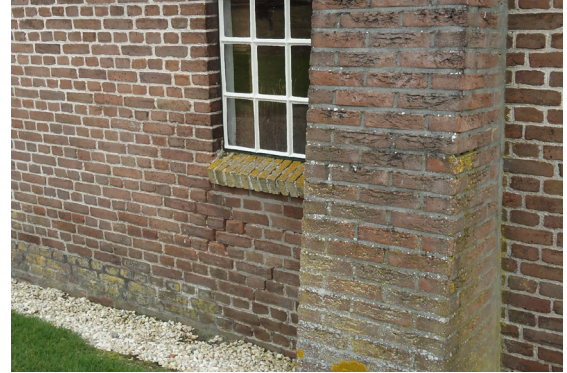
Rode baksteen, zoals op het erf op de hoek van de Hamersweg en de Idzardaweg (westkant)
