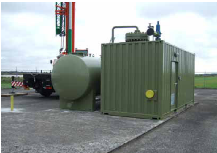
Figuur 4 Voorbeeld van een skid met daarnaast een bovengrondse tank
