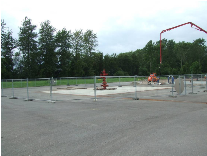
Figuur 2 Situatie locatie De Hoeve met daarop zichtbaar de afsluiter (spuitkruis) foto juli 2010
