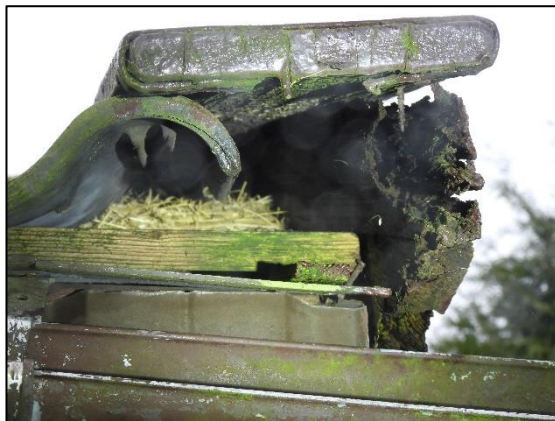
Afbeelding 2.22. Mogelijk nestmateriaal onder dakpannen.
