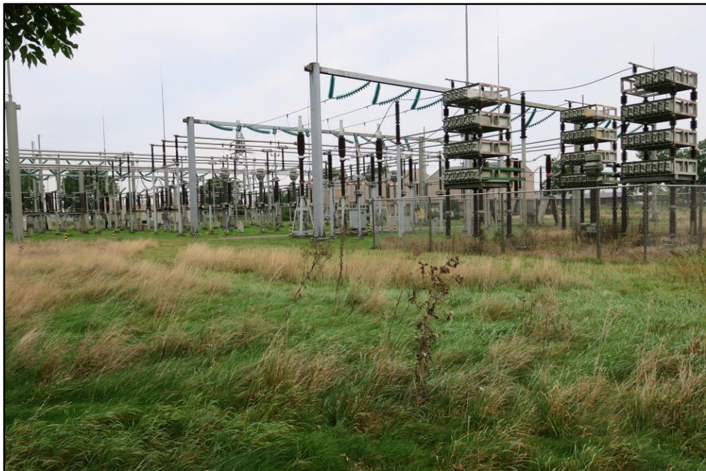
Figuur 2 Fotografische indruk van het transformatorstation op de planlocatie.
