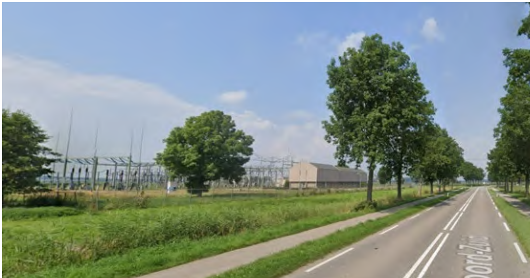
nu: onderstation & schakeltuin
