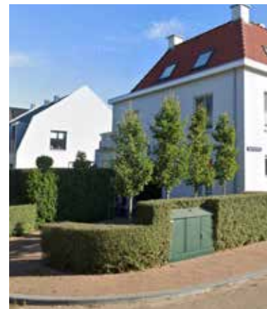
Technische ruimte in haag
