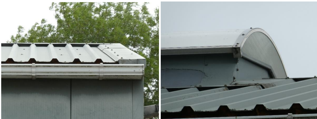
Afbeelding 9 en 10: bebouwing niet geschikt voor vaste verblijfplaatsen van de huismus. Bron: BNL advies. Datum: 26-07-2022
