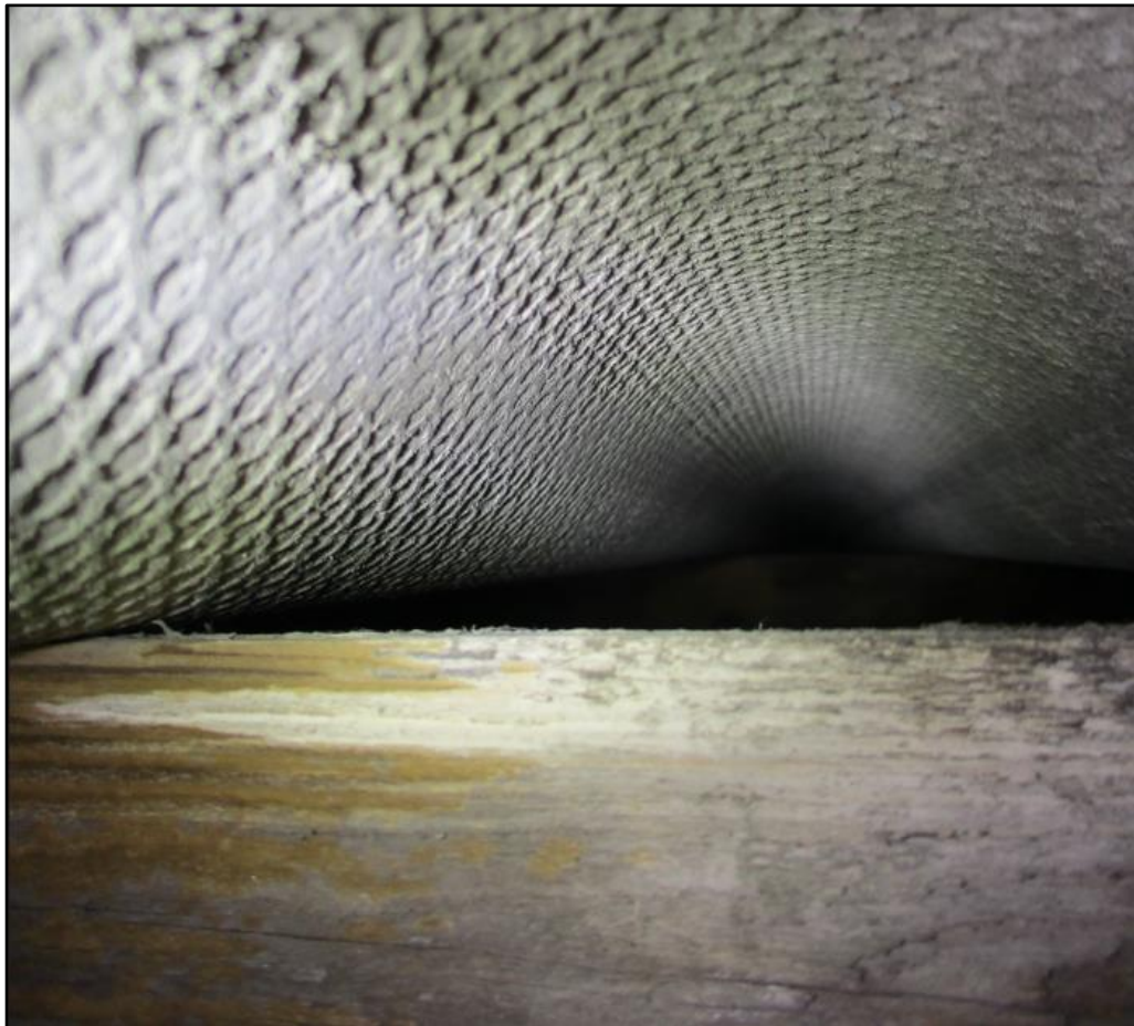
Figuur 2 Onder de golflaten op de bebouwing op de Karel Doormanstraat 23 en De Ruijterstraat 2B ontbreekt het aan dakbeschoot.
