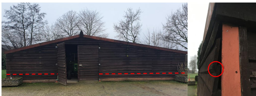
Figuur 3 Stippellijn geeft weer tot welke hoogte de gemetselde muren doorlopen achter de potdeksels (L). De overlap van de potdeksels (rood omcirkeld) is slechts enkele centimeters (R).
