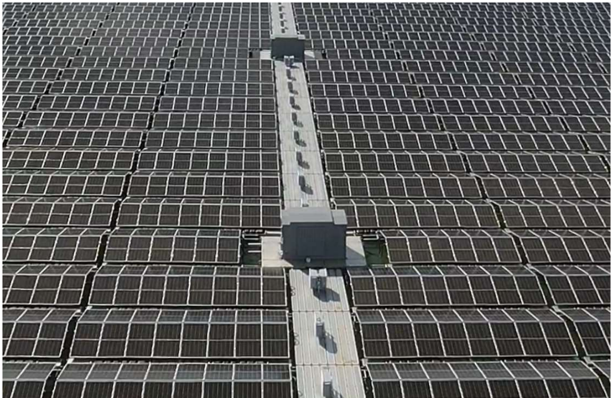
Figuur 2.3: Foto van de 'omvormer-straat' met daarin omvormers en transformators
