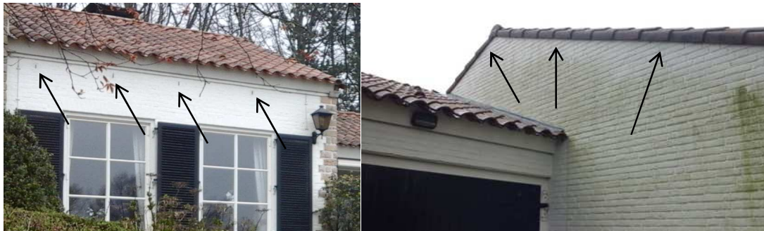
Potentiële invliegopeningen voor vleermuizen; eindpannen en open stootvoegen. Foto: auteur.
