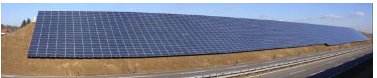
Afbeelding 3.6.: Zonne installatie langs de a94 dicht bij Toggion
