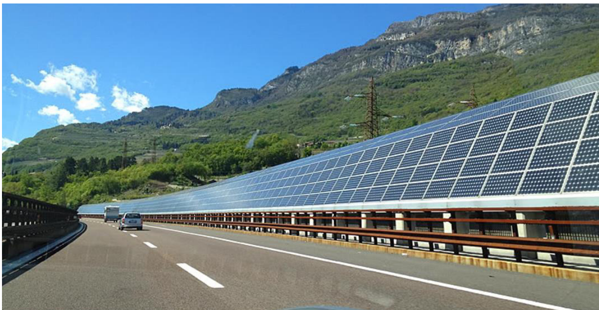
Afbeelding 25: Zonne installatie langs de "Brennerautobahn" in Italië
