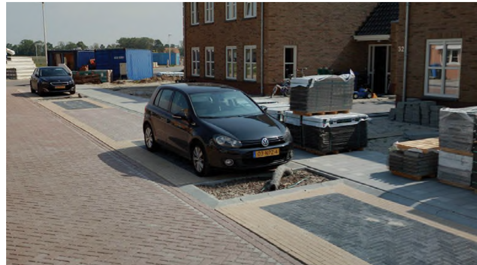
Rijbaan, langsparkeren gecombineerd met inrit naar erven 5/20 trottoirband toepassen waardoor geen inritblokken nodig zijn Zie ook detail 3
