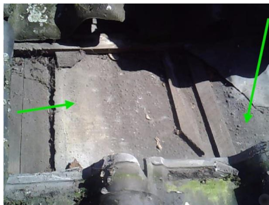
Foto 14. Niet-asbesthoudend dakleer Kruisakkers 20a
