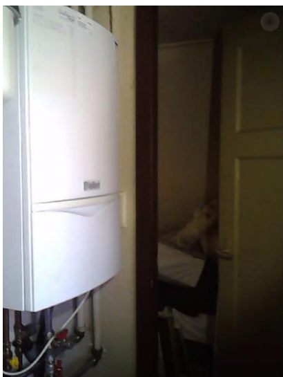
Foto 19. Niet-asbesthoudende cv-ketel Vaillant Solide VHR 18-22/3 Kruisakkers 18
