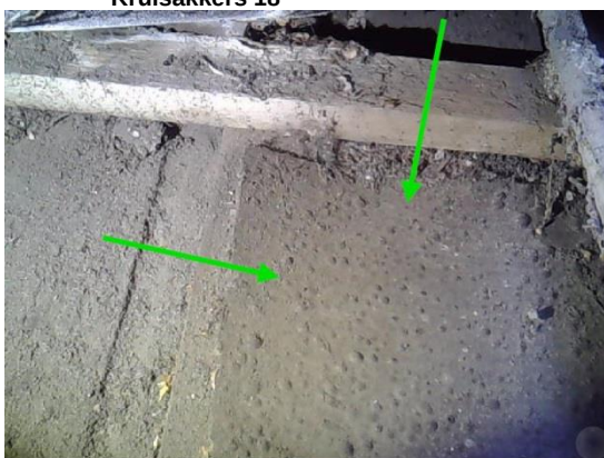
Foto 15. Niet-asbesthoudend dakleer Kruisakkers 20a
