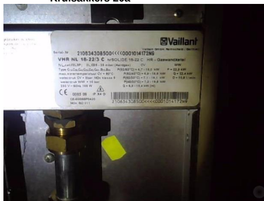
Foto 18. Niet-asbesthoudende cv-ketel Vaillant Solide VHR 18-22/3 Kruisakkers 24
