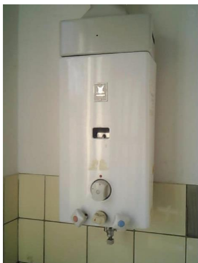
Foto 1. Asbesthoudende Vaillant geiser Kruisakker 20
