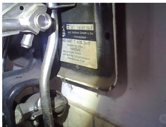
Foto 2. Asbesthoudende Vaillant geiser Kruisakker 20
