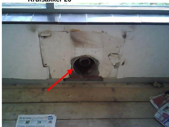
Foto 3. Asbesthoudende restanten koord Kruisakkers 20
