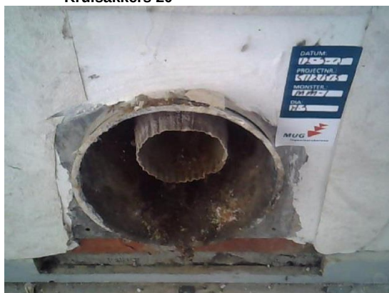
Foto 5. Asbesthoudende restanten koord Kruisakkers 20
