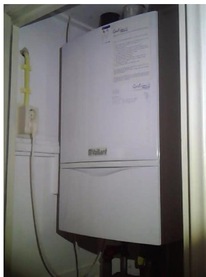
Foto 20. Niet-asbesthoudende cv-ketel Vaillant Solide VHR 18-22/3 Kruisakkers 22
