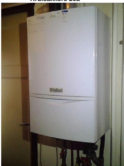
Foto 17. Niet-asbesthoudende cv-ketel Vaillant Solide VHR 18-22/3 Kruisakkers 24
