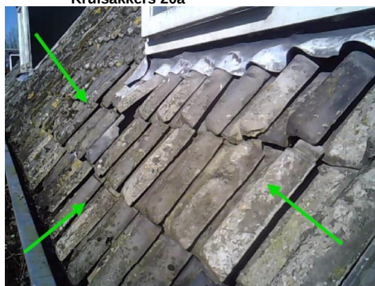
Foto 16. Niet-asbesthoudend dakleer Kruisakkers 20a
