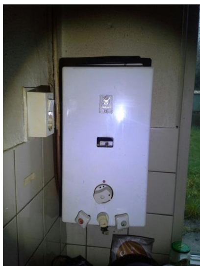
Foto 25. Asbesthoudende geiser Vaillant Kruisakkers 20a)
