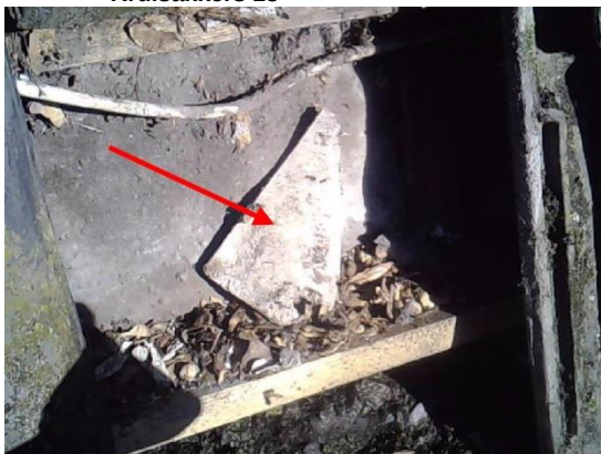
Foto 23. Asbesthoudende beplating Kruisakkers 20a (niet meer aanwezig)
