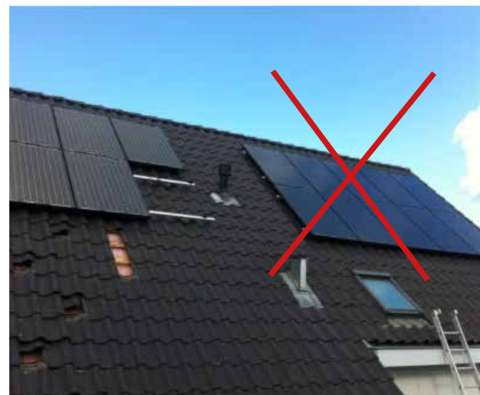
fout voorbeeld van zonnepanelen op het dak
