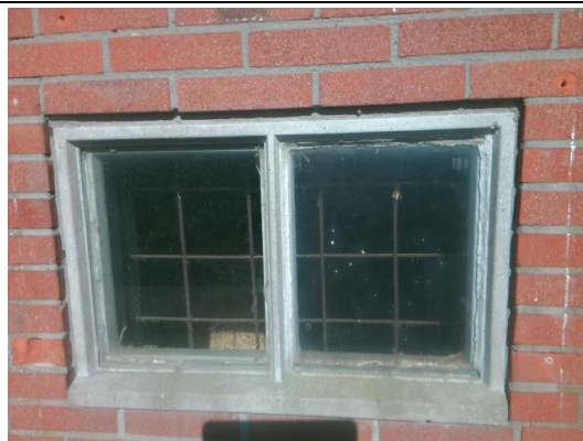
De beglazing in de betonnen kozijnen is vast gezet met specie, niet verdacht
