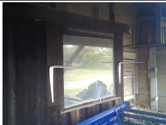
Kozijn zonder beglazingskit, niet verdacht
