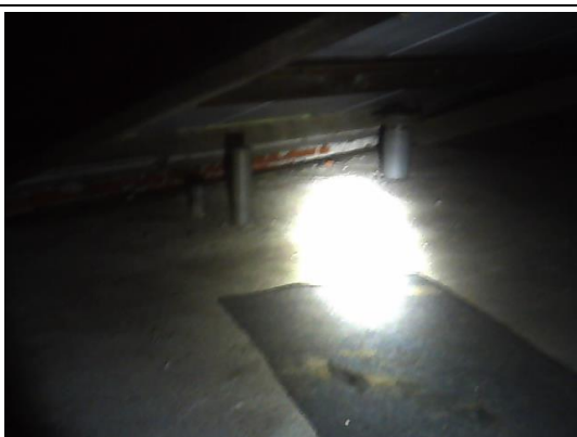
De ontluuchtingsbuizen op de zolder boven de toiletgroep zijn van pvc, niet verdacht
