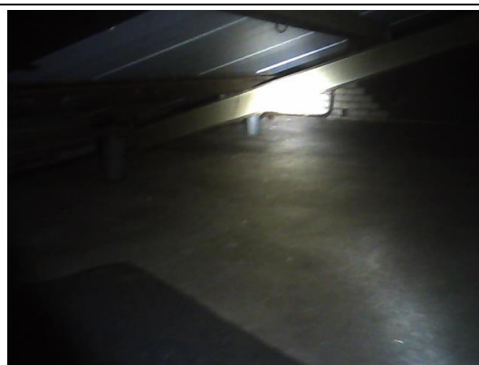
De ontluuchtingsbuizen op de zolder boven de toiletgroep zijn van pvc, niet verdacht
