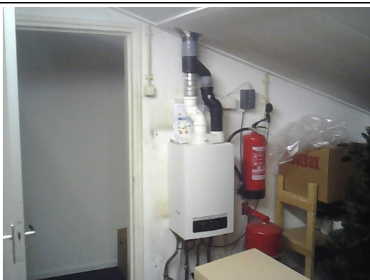
Cv-ketel in archiefruimte op zolder, niet verdacht
