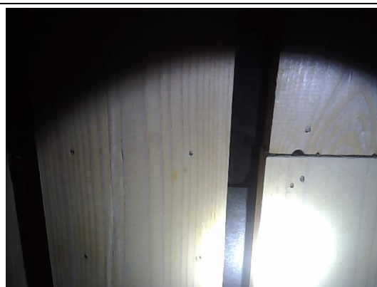
Vilt achter aftimmering van plafonds, niet verdacht
