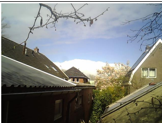
Dakplaten op dak van schuur buiten onderzoeksgebied, zie materiaal buiten toepassingsgebied
