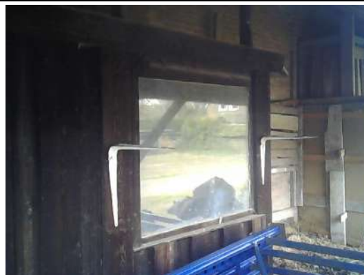
Kozijn zonder beglazingskit, niet verdacht
