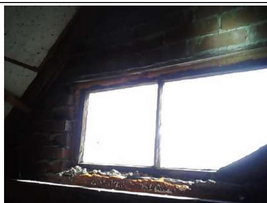
Kozijn op zolder van schuur 1 met stopverf, niet verdacht
