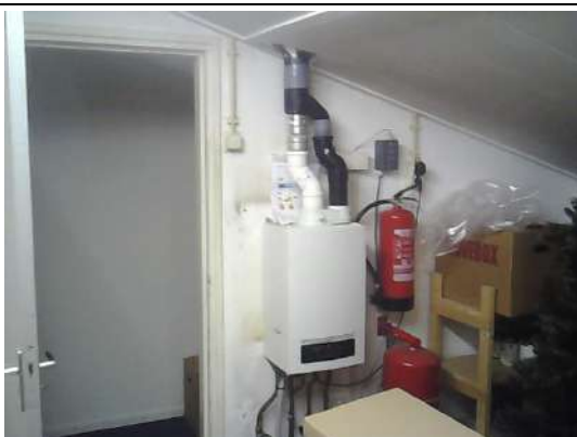
Cv-ketel in archiefruimte op zolder, niet verdacht
