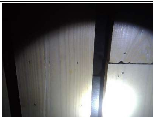
Vilt achter aftimmering van plafonds, niet verdacht
