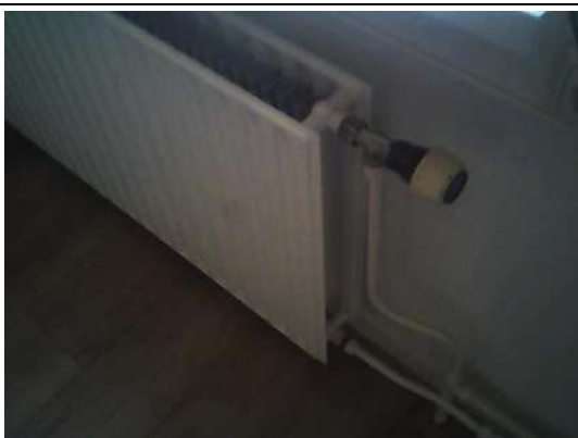
De radiatoren in het pand zijn gelast, niet verdacht
