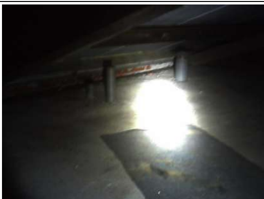
De ontluichtingsbuizen op de zolder boven de toiletgroep zijn van pvc, niet verdacht
