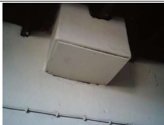
Het plaat materiaal aan de onderzijde van het gemetselde rookkanaal is van hout.
