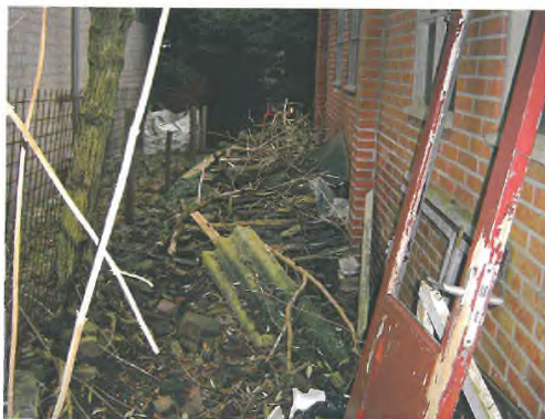
Foto 5: locatie aan de linkerkzijde (asbesthoudende puinstort)
