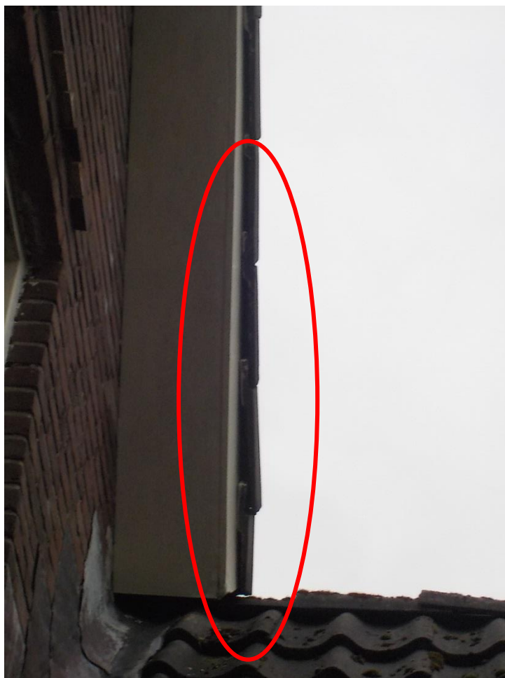
Foto 3 Rode cirkel geeft de ruimte tussen de gevelpannen aan die geschikt als verblijfplaats voor vleermuizen.
