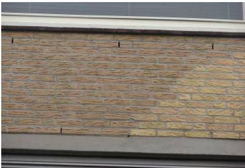
Open stootvoegen op de eerste verdieping.
