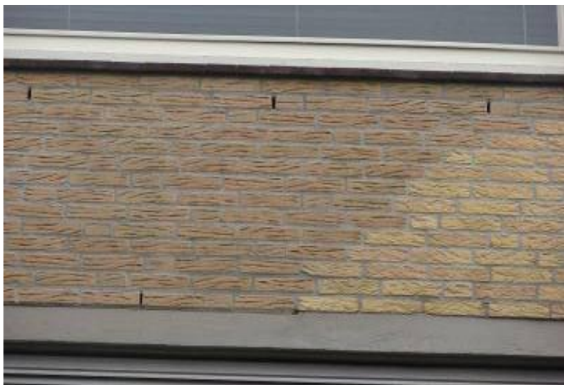
Open stootvoegen op de eerste verdieping.
