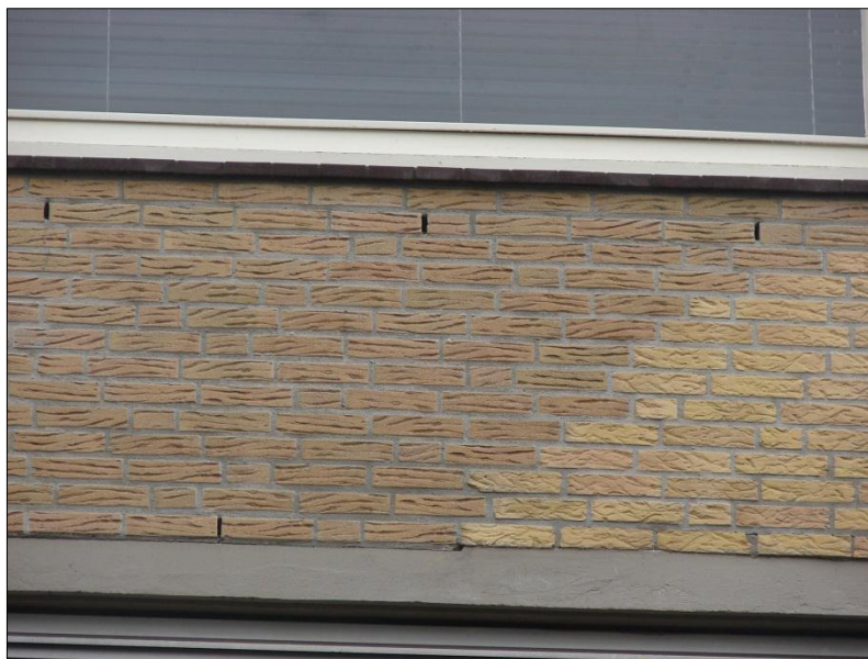
Open stootvoegen in het schoolgebouw
