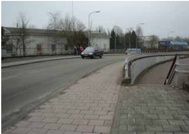
Rolderhoofdweg: kwaliteit fietspad onvoldoende
