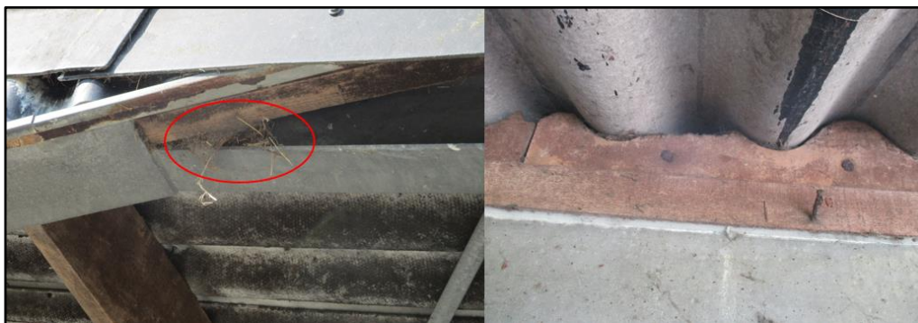
Figuur 4 Nestmateriaal, zeer aannemelijk van huismus, in het dak van de melkstal. En toegang tot de ruimte tussen het dak en dakbeschot aan de buitenzijde van de melkstal en jongveestal.
