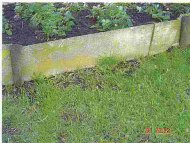
Fotonummer: 14 Omschrijving: Asbestverdacht materiaal volkstuintjes
