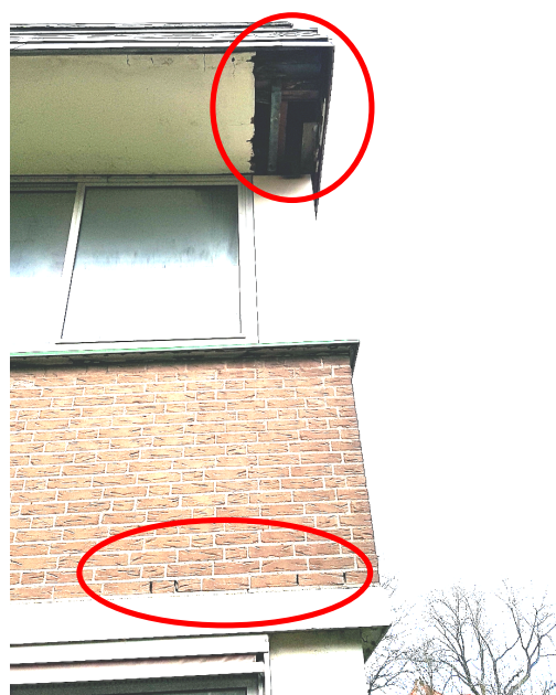
Afbeelding 10. Open stootvoegen en openingen onder het schuine geveldeel/ dak
