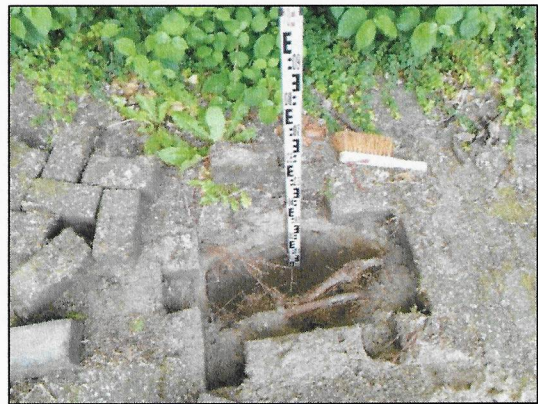
Figuur 5 Oppervlakkige beworteling onder bestrating
