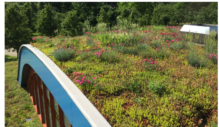
Groen dak ten behoeve van de lokale biodiversiteit, het verkoelen en vasthouden van hemelwater
