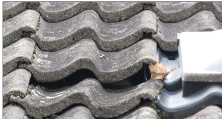
Figuur: op het dak van het woonhuis ligt een losse dakpan. Hier kunnen huismussen onder broeden. Verder kunnen vleermuizen hier onder het dak kruipen.
