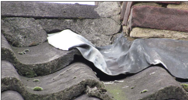
Figuur: via het openstaande daklood kunnen vleermuizen mogelijk onder het dak komen en hier kunnen ze een verblijfplaats hebben.
